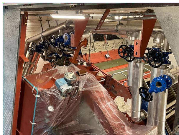
Ausgebauter Kühler Maschinengruppe 1
