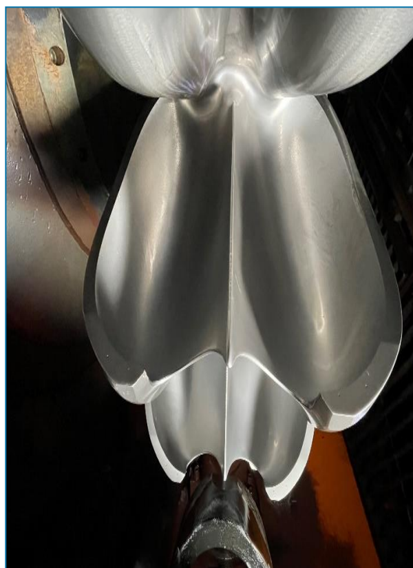
Turbinenrad Maschinengruppe 1 nach ca. 2'000 Betriebsstunden
