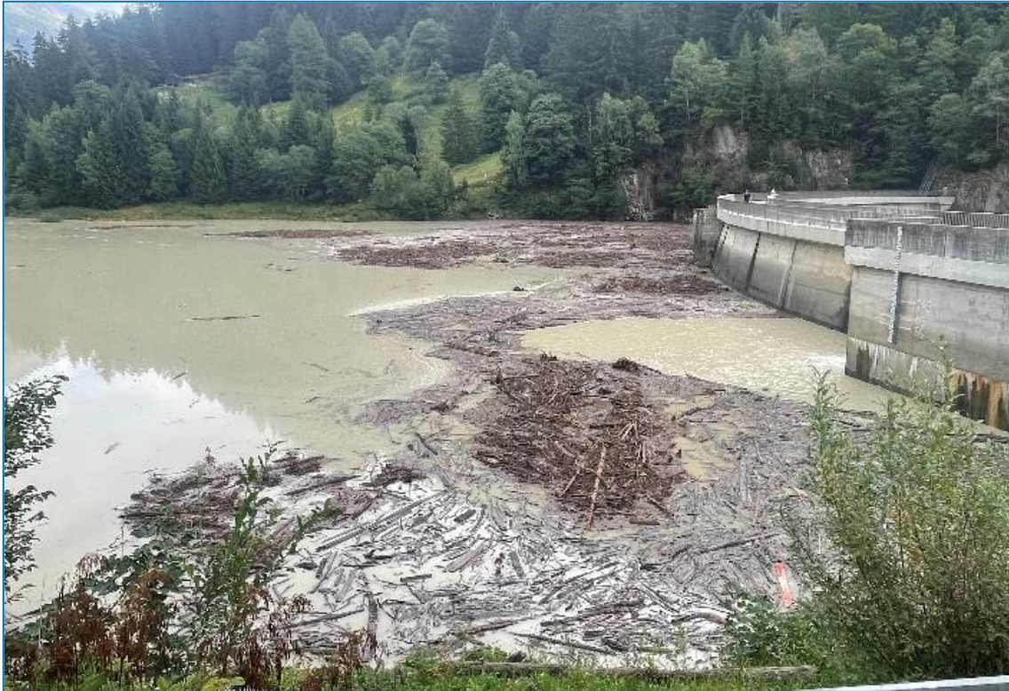
Staumauer Ferden: Das Hochwasser transportierte sehr viel Schwemmholz in den See.
